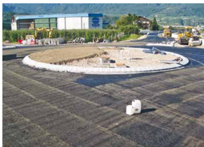
8. Nella realizzazione di una rotatoria ad Appiano (BZ), l'applicazione della rete di armatura in fibra di carbonio per ottenere l'aumento del valore strutturale di circa 4 cm di asfalto, con il conseguente scarico delle forze agenti verso l'esterno per un aumento della vita utile della pavimentazione
