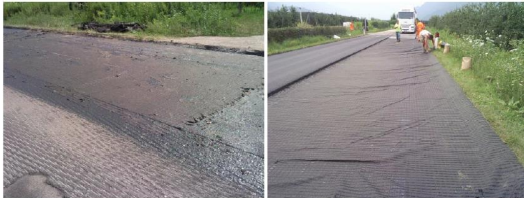
Figura 12 – Inconvenienti di posa in opera del geocomposito HaTelit® (2010)
